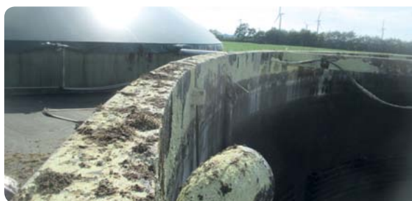
Un béton détérioré pouvant être traité avec nos produits
