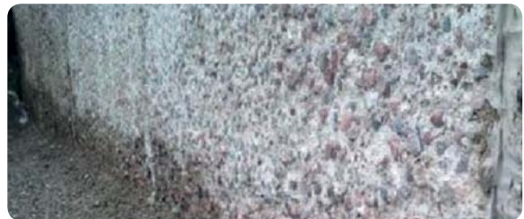
Réhabilitation possible d'ouvrages fortement dégradés
